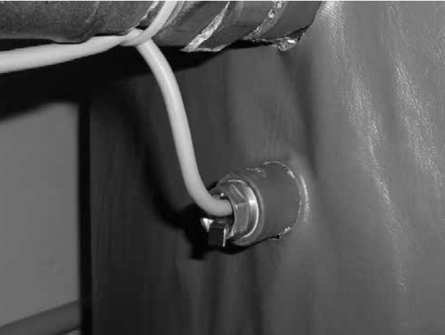
Obr. 13 - pohled na čidlo teploty vody v jímce akumulární nádrže (TV a TS)
